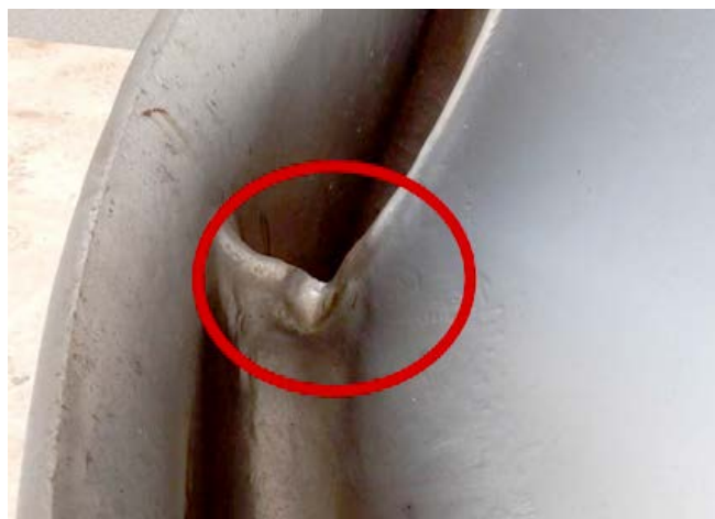
Рис. 1. Выборка металла в зоне сопряжения лопасти с ободом (красным овалом отмечена зона выборки)
