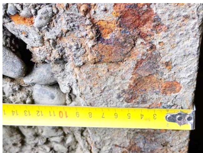
Рис. 3. Коррозионный износ металлической части паза затвора отсасывающей трубы
