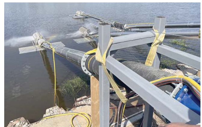
Рис. 2. Водозаборные устройства Riverscreen 12" с всасывающими алюминиевыми трубопроводами на понтонах
